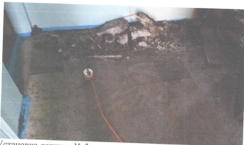
Рис. 5. Установка датчика № 2 на полу лестничной площадки первого этажа.
