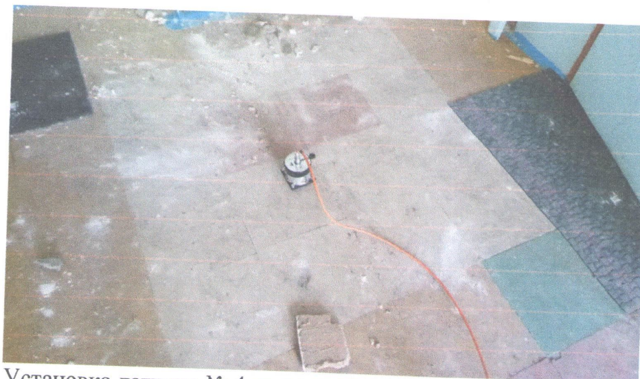
Рис. 6. Установка датчика № 3 на полу лестничной площадки третьего этажа.
